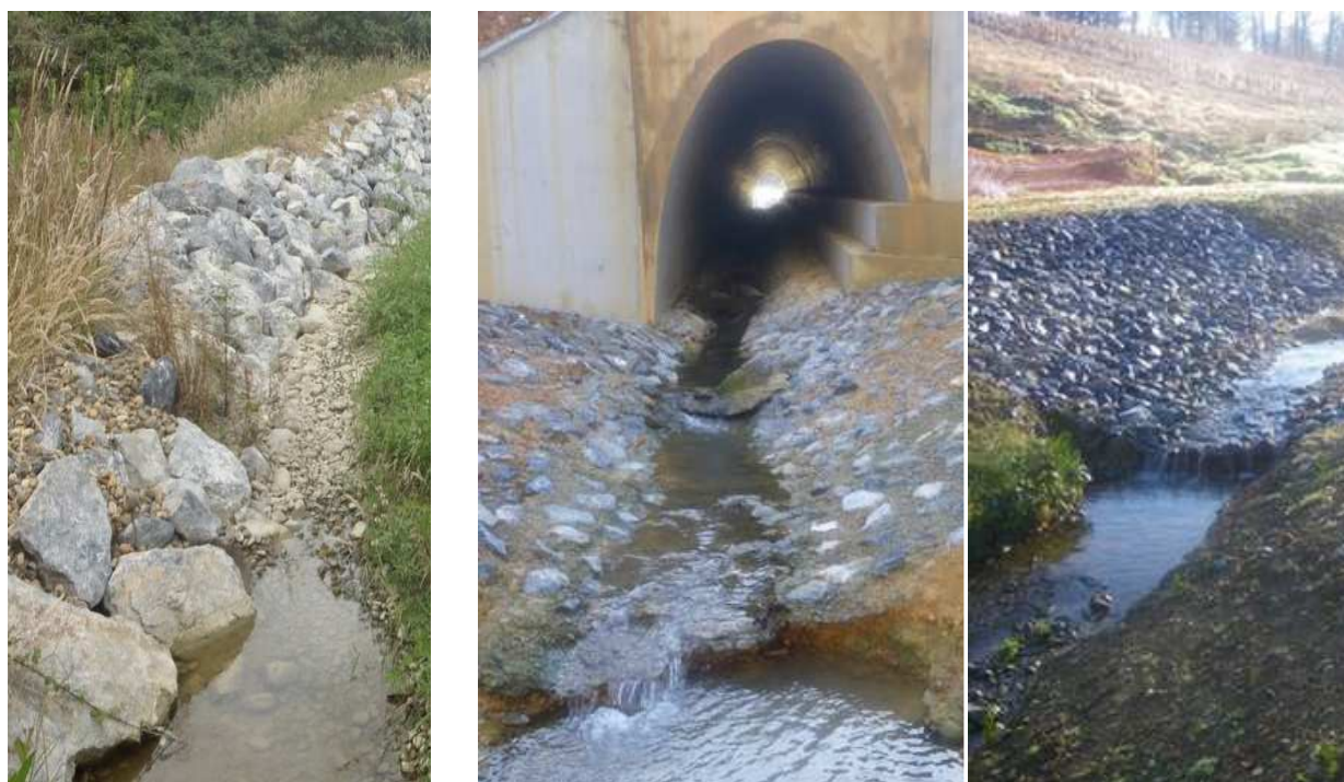
☹ Pertes hydrauliques liées à l'utilisation d'un substrat perméable. Ruptures de pente engendrant des chutes infranchissables par les poissons en aval immédiat (1) d'un ouvrage de franchissement hydraulique ; et (2) d'un seuil de stabilisation du lit mineur et des berges au sein d'une dérivation de cours d'eau (Source : Onema)
